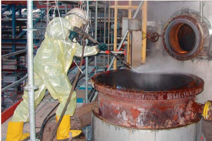
Ein Veolia-Mitarbeiter reinigt mit einer Hochdruck-Düse einen Wärmetauscher (Foto: Veolia)
