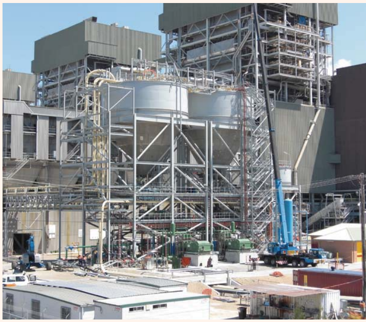
Die hochmoderne Entschungsanlage für ein australisches Kraftwerk war mit umgerechnet 38 Mio. Euro der größte Auftrag dieses Geschäftsbereiches in der Firmengeschichte (Foto: Clyde Bergemann)
