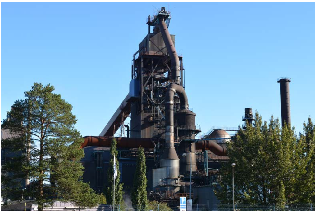
(SSAB_Lulea_copyright_SSAB.jpg) Stahlwerk von SSAB im schwedischen Luleå: Der Einsatz als Hochofengebläse stellt hier besondere Anforderungen an die Kompressortechnologie.
