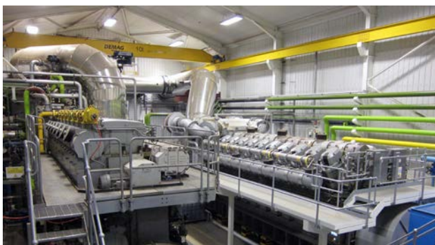
Bild: Im Inneren des Kraftwerks
